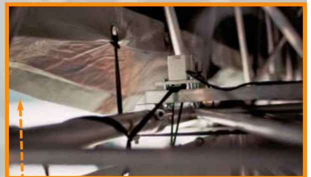
Installierter Halteriegel mit pneumatischem Zylinder Installed bar with pneumatic cylinder
